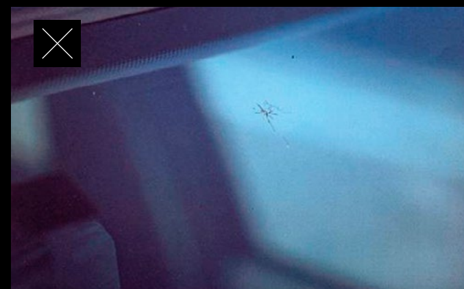
Absplitterung mit Anzeichen von Rissbildung
