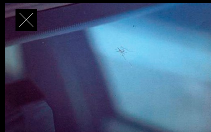
Absplitterung mit Anzeichen von Rissbildung
